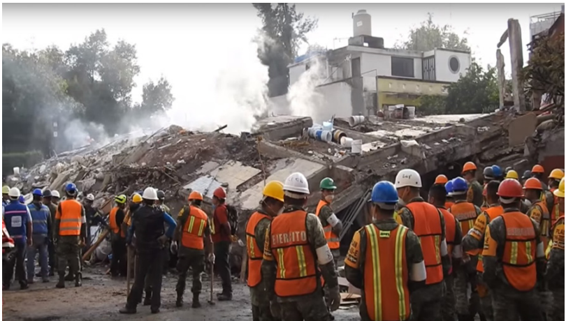
Figura 3. Edificio colapsado Prolongación Petén 915, Esquina Emiliano Zapata
